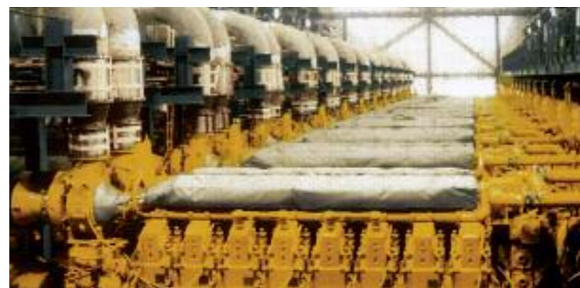
Dreizehn 3616 Schweröl-Dieselmotoren im Netzbetrieb
