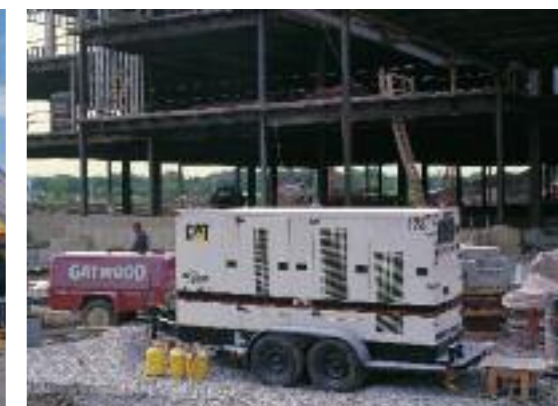
Strom für den Bau: mobiles Cat Aggregat im Einsatz
